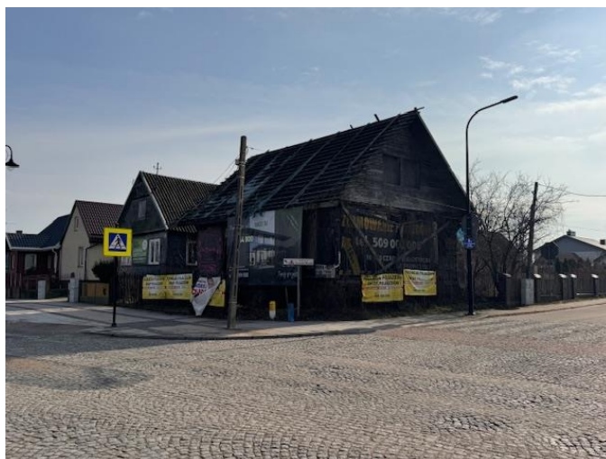
Rysunek 23. Brak ładu przestrzennego i zdegradowanego obiektu mieszkalnego (pustostan).
